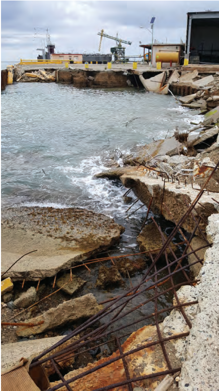
Daño en el puerto de Mayagüez
