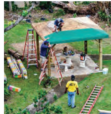
Los conductores del contratista de FEMA Estes Express Lines trabajaron como voluntarios en el Hogar Escuela Sor María Rafaela para niñas en Bayamón el 1 de febrero de 2018. Los voluntarios repararon techos, mesas, bancos y equipos de juegos dañados durante su tiempo libre.
